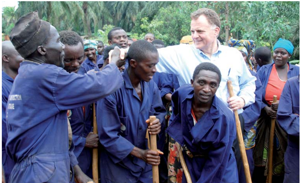
M. Ryan, Directeur du BCPR, participe aux travaux de traçage de route à Rumonge
